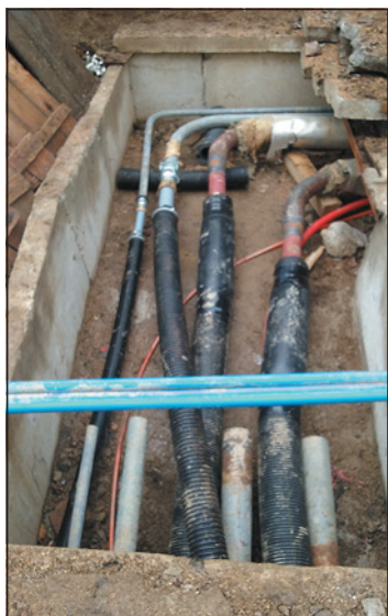
▲ Obr. 4 ● Na zdravé části původního ocelového potrubí UT byly navazovány varné přechody ocel/PB v kanále (na obrázku) i v domě pod armaturami
